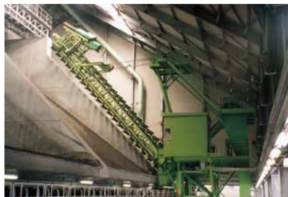
リクレーマ(スクレーパタイプ) 取扱物：クリンカ灰
