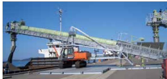
移動式ベルトコンベヤ 取扱物：クリンカ灰など
