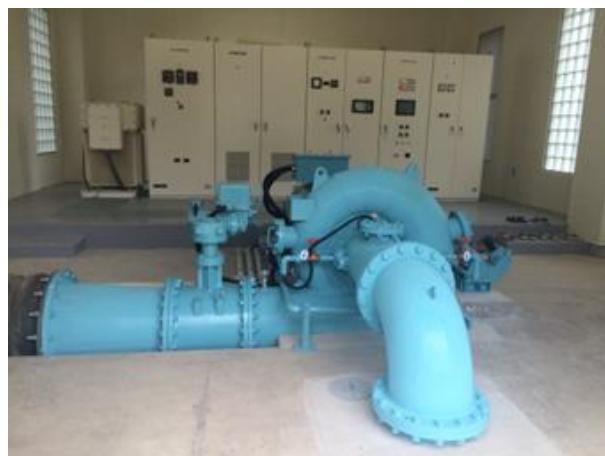
(新石見小水力発電所で稼働する当社製小水力発電設備)
